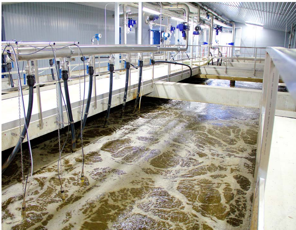
Kuva 7. Jätevedenpuhdistamon ilmastuksen laajennusosa.
