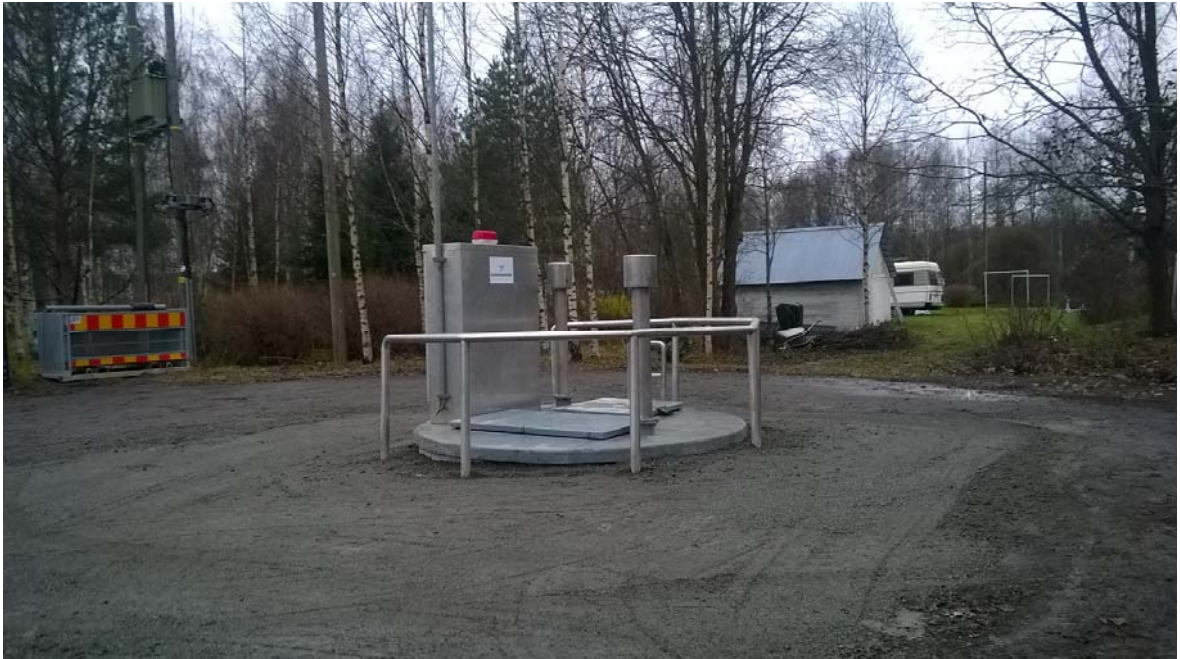
Kuva 8. Vuonna 2014 saneerattu Tuuliala 2 jätevedenpumppaamo.
